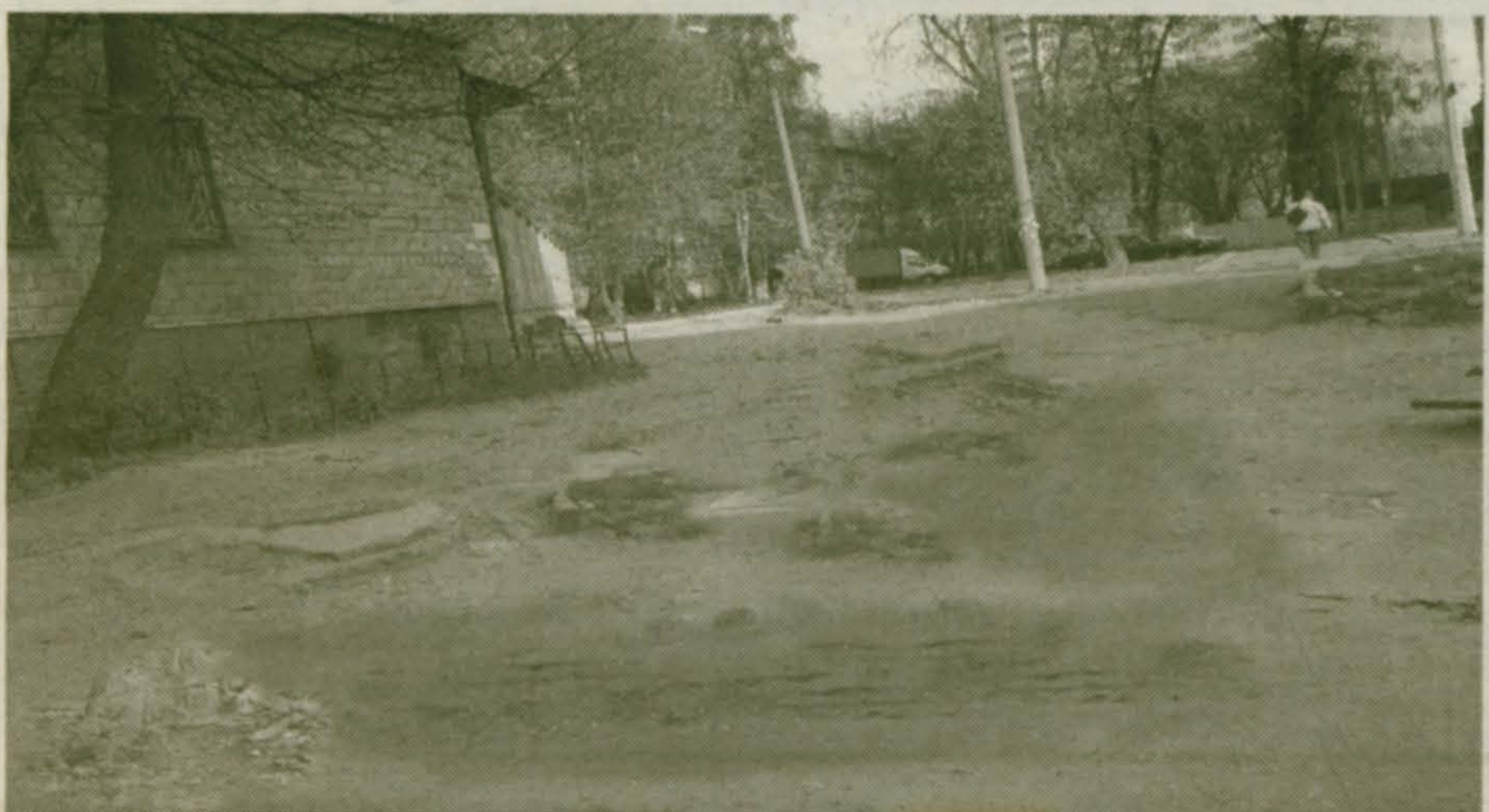
А это самый центр поселка. Улица К. Маркса. 100 метров от администрации. Всё те же грязь и разбитые дороги. На половине подземных колодцев нет люков. Прикрывают сами жильцы, кто куском фанеры, кто старой дверью.
