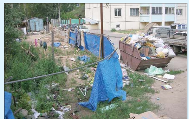
Красково, ул. К. Маркса, 81, 83. Переполненный контейнер и бытовой мусор на территории стройки ООО «Лидер-Строй» (ген. директор А.Д. Куликов). Фото Валерия Дроздова
