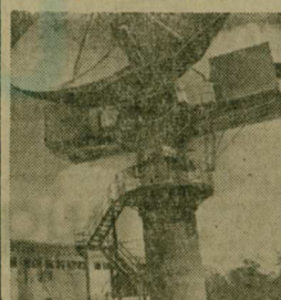
Лас. Наземная станция космической связи системы «Интерспутник» (на снимке), расположенная близ лаосской столицы, обеспечивает сегодня надежную телефонную и телеграфную связь, а также прием телевизионных передач из СССР и других социалистических стран. Она воздвигалась совместно строителями ЛДР и Советского Союза. Строительство станции стало новым свидетельством постоянно крепнущей советско-лаосской дружбы. (Фотохроника ТАСС.)
