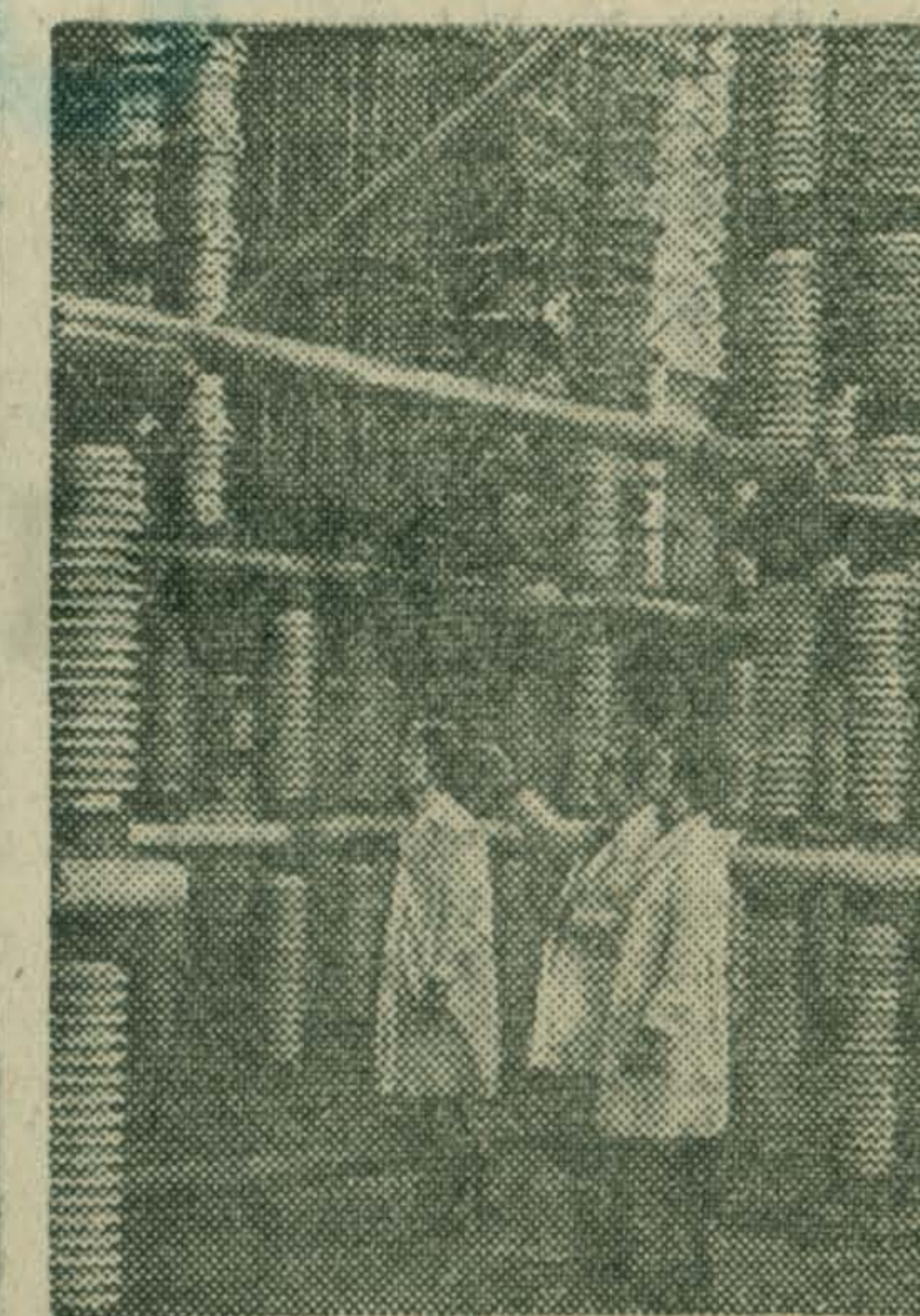
Тольятти. Мощный испытательный стенд для отработки и проверки преобразовательного оборудования, предназначенного для первой в стране линии электропередачи постоянного тока «Экибастуз-Центр», начал действовать в отделении Всесоюзного электротехнического института имени Ленина.
