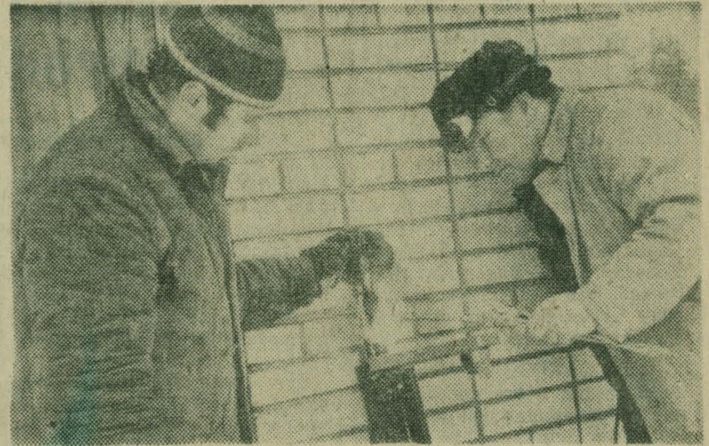
Бригада Люберецкого участка № 1, которой руководит Н. И. Рамейков, — один из лучших коллективов в строительном управлении № 9 Союзгазпромстроя. Сейчас, например, коллектив ведет сантехнические работы на детском санаторном комплексе в пос. Ильинская. Всего шесть дней потребовалось сантехникам, чтобы дать тепло в один из корпусов санатория, что позволило раньше срока приступить к работам. На снимке: бригадир Н. И. РАМЕЙКОВ (слева) и газосварщик 6-го разряда В. К. ДЯКЕН. Фото Н. ПРОХНЕРА.
