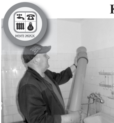
Сотрудниками МУП ЖКХ ГП Малаховка устранена течь тру-
